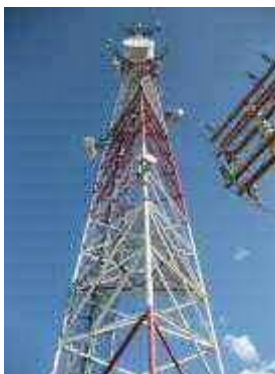
Radio Base para retransmisión de señal en Santa Cruz
