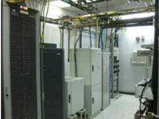
Gabinete HUAWEI para procesos GSM
