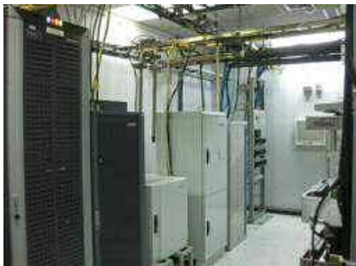
Gabinete HUAWEI para procesos GSM
