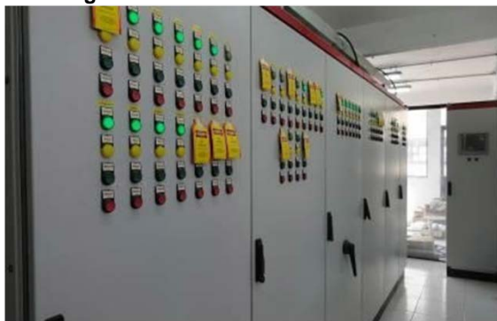
Fotografía 3: Automatización de la Planta
