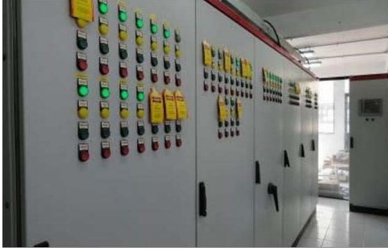
Fotografía 3: Automatización de la Planta
