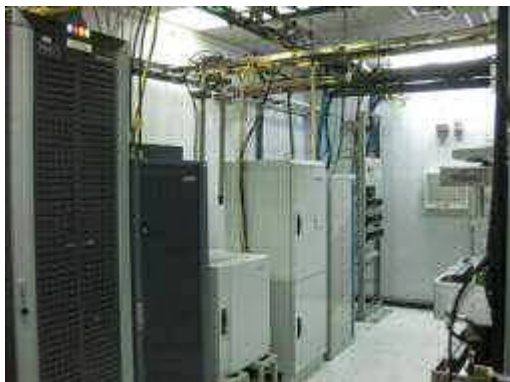
Gabinete HUAWEI para procesos GSM
